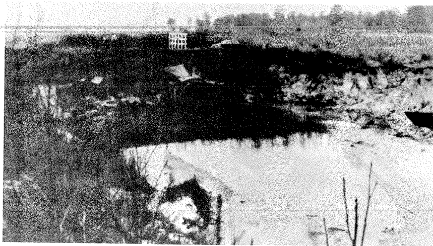
a. Embankment erosion
